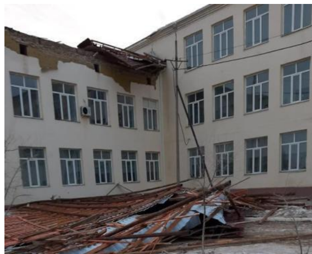
Рис. 11, б. Обрушенная кровля сельской школы-интернат в поселке Макат [23] Fig. 11, b. Blasted roof of the school in Makat village [23]
