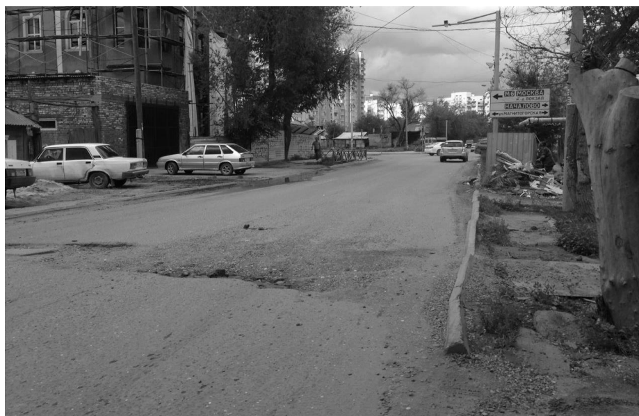
Рис. 2. Нарушенное дорожное полотно
